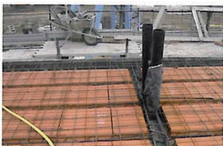
Vista di un solaio di piano in laterocemento in fase di costruzione
